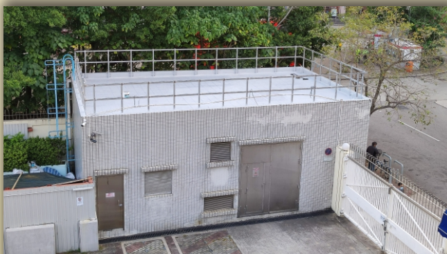
新建設 電掣房天台的安全欄杆
